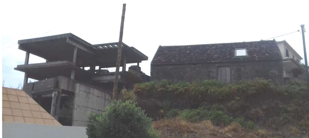
Figura 12 – Edifício em mau estado
